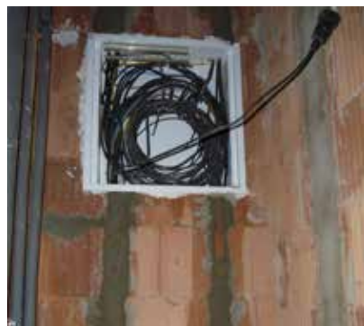
Rozvody by sa pred omietnutím mali riadne zapraviť maltou.
