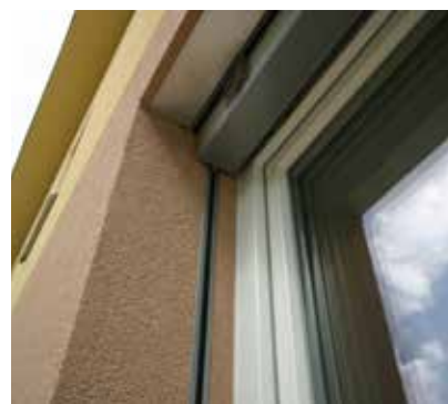
14 Pohľad na finálne zhotovenie stavebného otvoru so žalúziou v roletovom a žalúziom preklade HELUZ.
