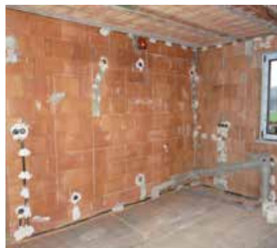
Pohľad na zabudované elektroinštaláčne škatule a rozvedené káble. Drážky na rozvody vody a kanalizácie musia byť čo najmenšie.
