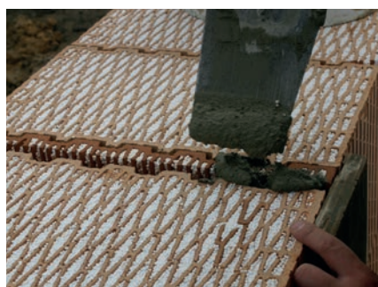
Mezery mezi cihlami, je nutné vyplnit maltou nebo dořezem cihly a promaltováním (v případě zdění na PU pěnu propěněním dvěma pruhy).
