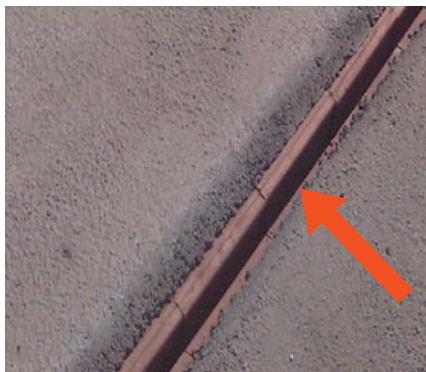
② Styčné spáry mezi stropními panely se musí před betonáží (zejména keramická část) řádně navlhčit.
