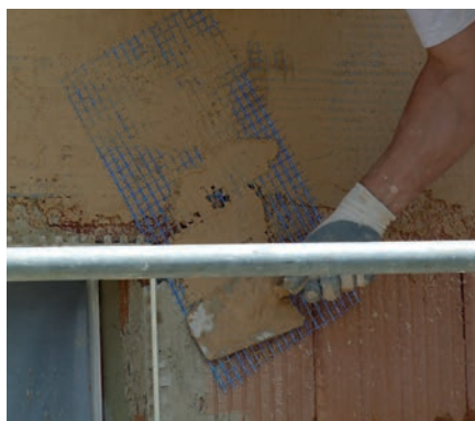
⑦ V místě rohů stavebních otvorů se omítka vyztuží sklotextilní síťovinou (oko min. 8x8mm), aby se předešlo možnému vzniku trhlin omítky v rohu.
