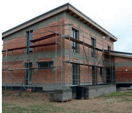
④ Příprava stavby před omítáním. Před omítáním se případně vyspraví zdivo a ošetří se exponovanější místa konstrukčních detailů.
